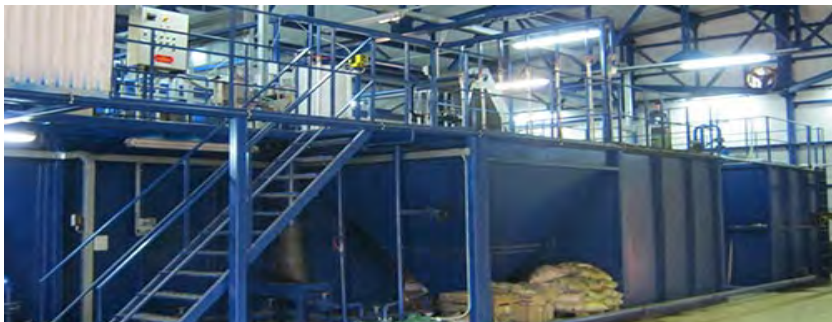
д. Лемболово, Ленинградская область. Воинская часть 46/16 Очистные сооружения хозяйственно бытового стока Производительность 400 м 3 /сут.
