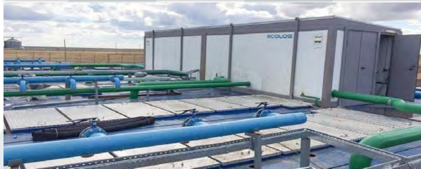
с. Денисовка, Костанайская обл. Поселковые очистные сооружения наземного типа. Производительность 800 м 3 /сут.
