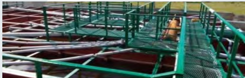
г. Шардара, Южно-Казахстанская обл., Республика Казахстан. Поселковые очистные сооружения наземного типа. Производительность 2 000 м 3 /сут.
