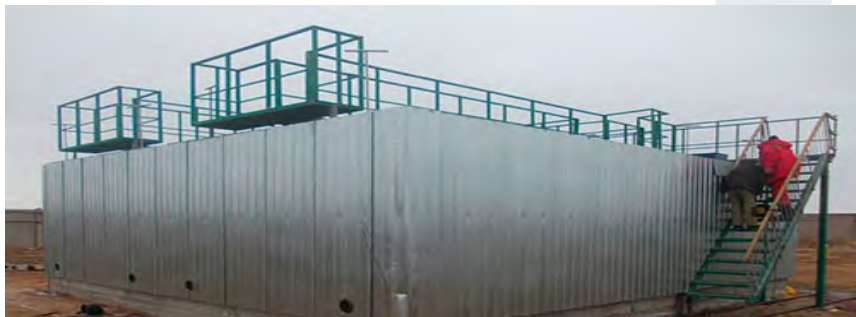
Нижегородская область, Тоншаево Очистные сооружения хозяйственно-бытовых сточных вод ЛОС-Р. Производительность 400 м 3 /сут
