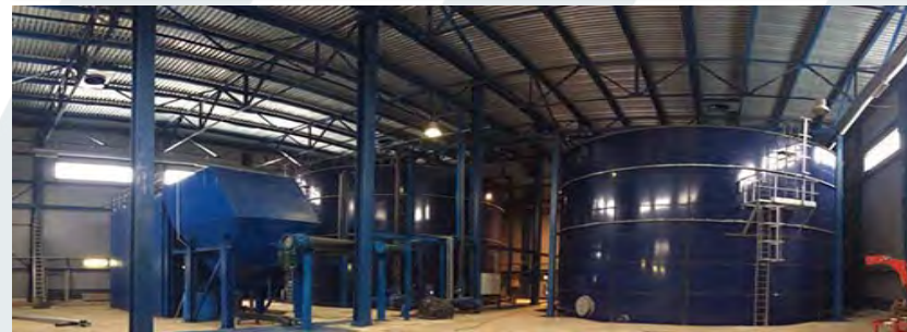
г. Москва. Очистные сооружения хозяйственно-бытовых сточных вод. Поставка, проведение строительно-монтажных, пуско-наладочных работ, запуск. Производительность 4 200 м 3 /сут.
