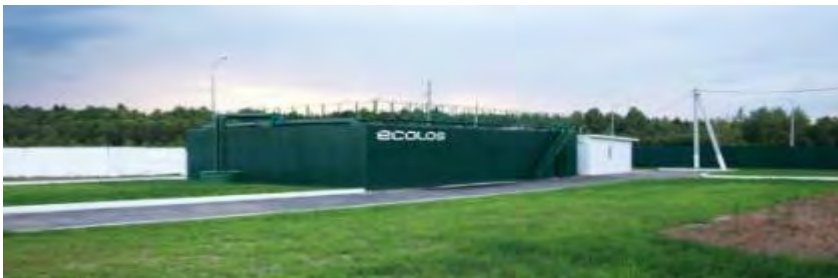
п. Тоншаево, Нижегородская область Очистные сооружения хозяйственно-бытовых сточных вод
