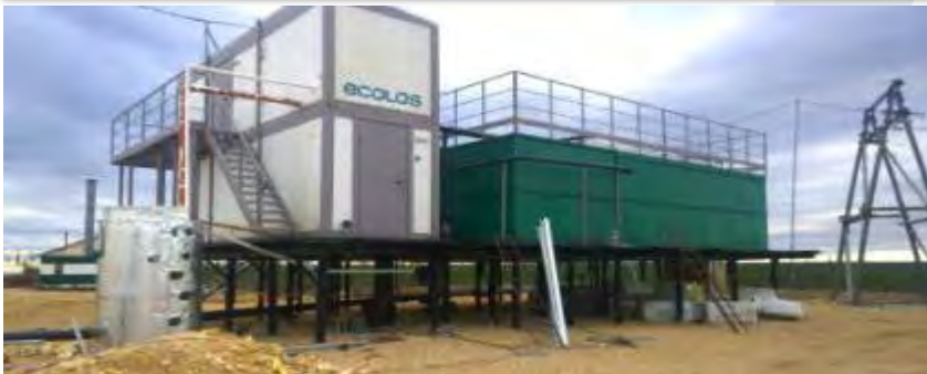
Вахтовый поселок Эбелях ( Республика Саха) Очистные сооружения производительностью 150 м 3 /сут и водоподготовка 100 м 3 /сут.
