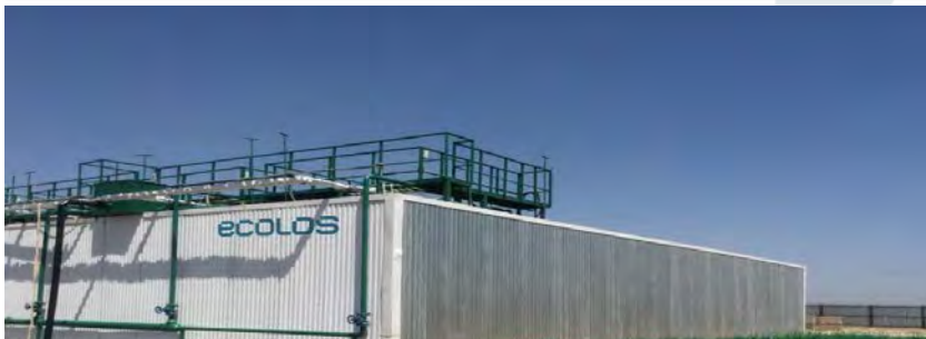
Казахстан, Южно-Казахстанская область, п. Шардара Поселковые очистные сооружения производительностью 2000 м 3 /сут, Проектирование, изготовление, СМР
