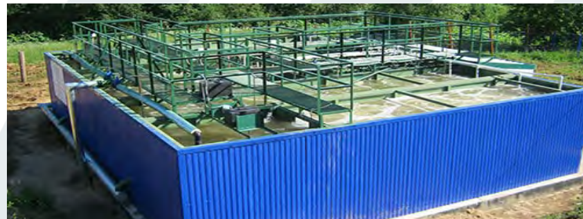
Золотое кольцо, Ярославская область Станция биологической очистки ЛОС-Р-400 Поставка оборудования, шефмонтажные, пусконаладочные работы. Производительность 400 м 3 /сут
