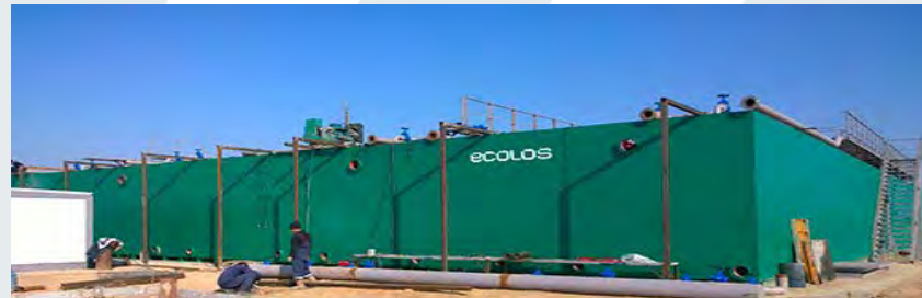
г. Жетысай, республика Казахстан Очистные сооружения биологической очистки типа ЛОС-Р Поставка оборудования, шефмонтажные и пусконаладочные работы. Производительность 3 400 м 3 /сут.
